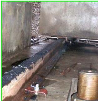
Vue coté intérieur sur le rail graissé et le patin de glissement
