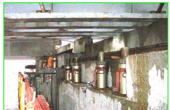
Verins 75 tonnes en attente sur les culées pour la mise sur appuis après ripage
