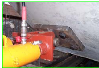
Platine d'ancrage des verins pousseurs boulonnée sur la contre-platine
