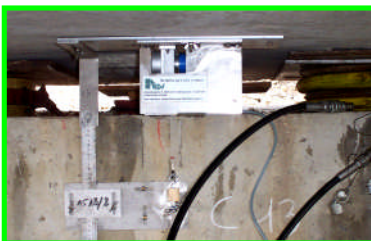
Capteur de déplacement Associé au réglé de secours
