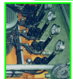
Electrovannes et manomètres sur centrale
